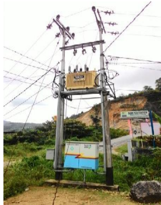
Gambar 2 Gardu depan kantor rayon (160 kVA)
